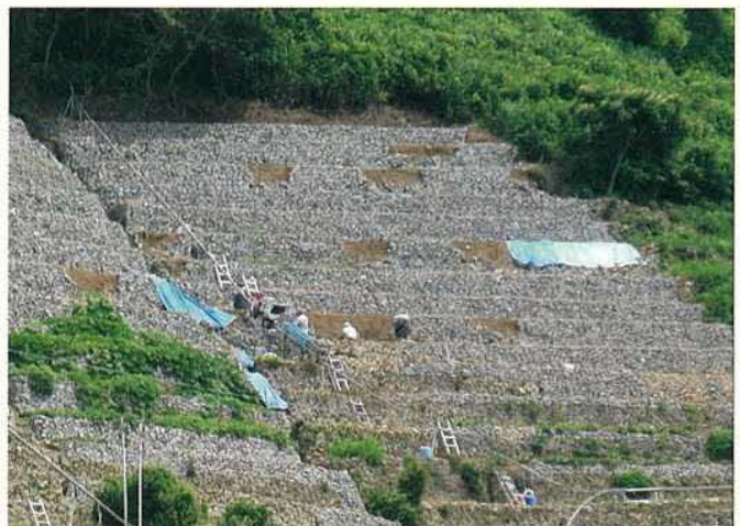
記録的な降雨による石垣の崩落
