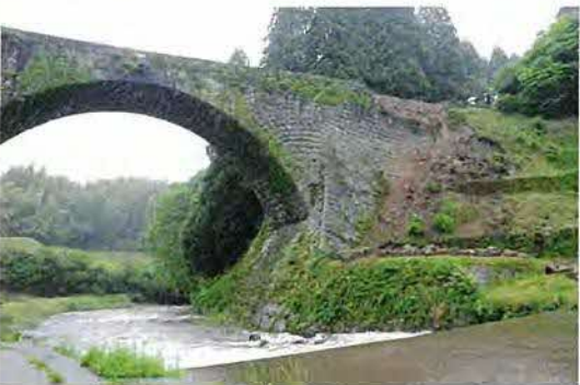
平成 30 年 5 月 7 日 壁石垣崩落直後の通潤橋
